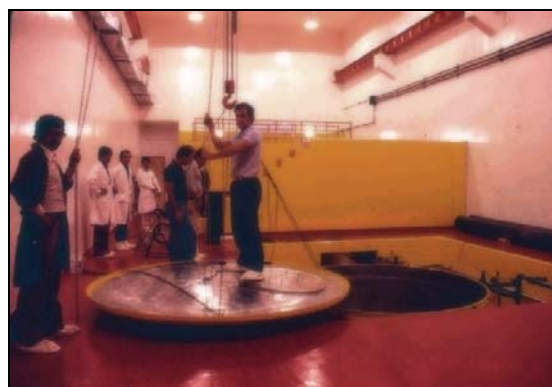
Terminación de la pileta del reactor. Nótese la pintura especial para interiores de reactores y centrales en las paredes del edificio.
