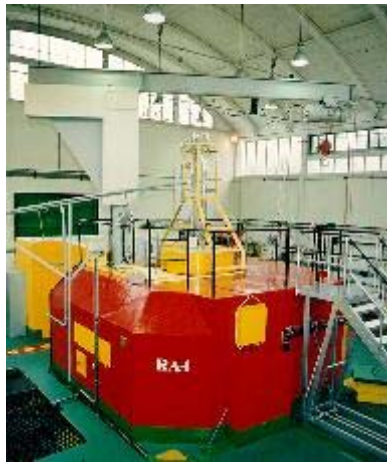
Reactor RA-1 de la CNEA en instalaciones de la UA-RCN del CAC.
