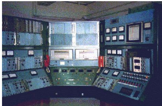
Sala de Control
