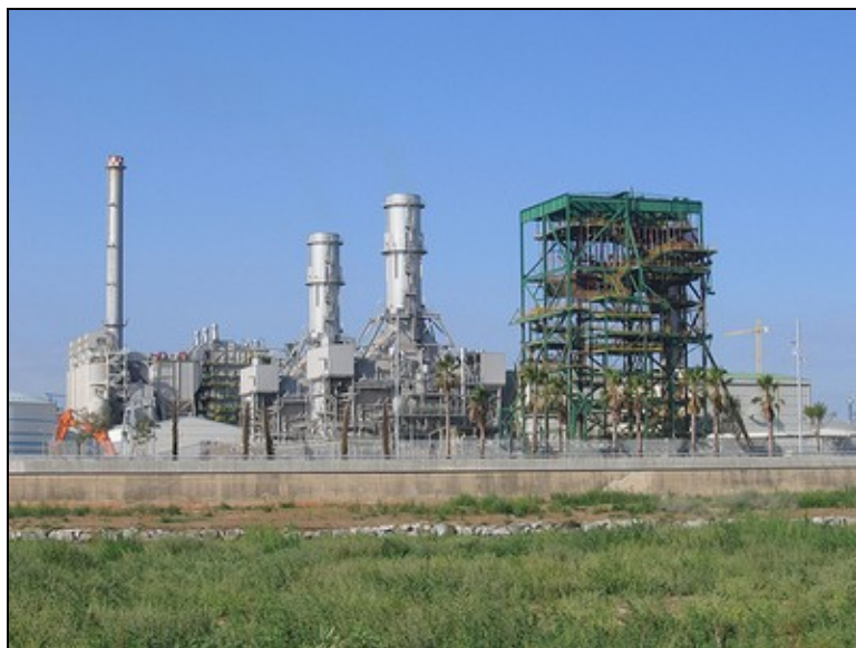
Central termoeléctrica Ensenada de Barragán en plena construcción a comienzos de Octubre de 2011. Imagen: NOVA La Plata, http://www.novalaplata.com/nota.asp?n=2011_10_12&id=28344&id_tiponota=36
